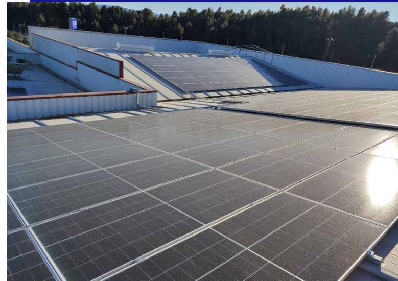
Vista general Campo Fotovoltaico
