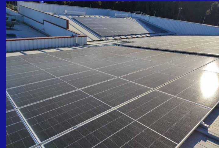
Vista general Campo Fotovoltaico
