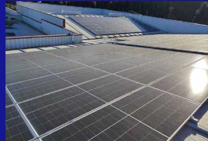
Vista general Campo Fotovoltaico
